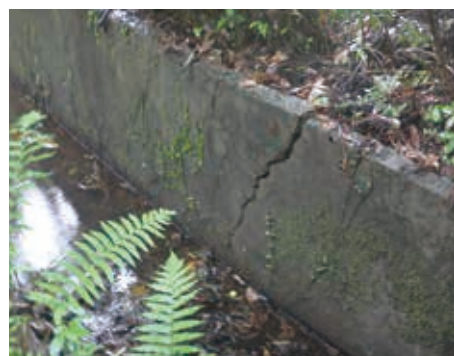
構造物のひび割れ
